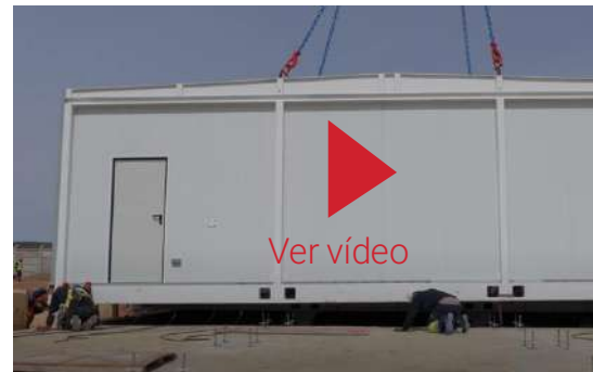
Subestación Punta de Talca
